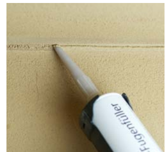
Füllung eines Abrisses zwischen Decken- und Wandbauteil
